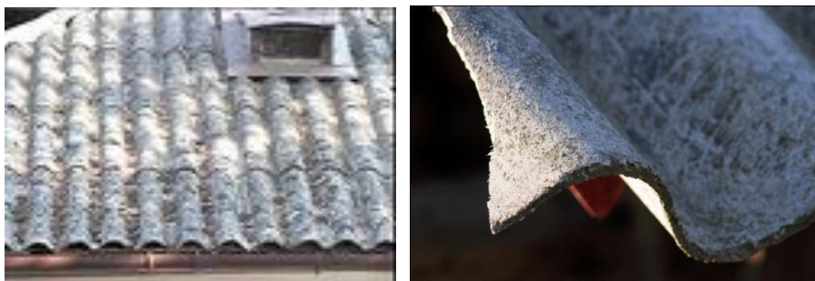
Zdjęcie 7 Płyty faliste azbestowo-cementowych
