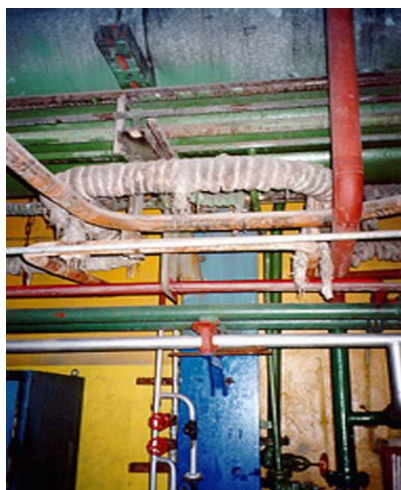
Zdjęcie 11 Izolacja rurociągów ze sznurów azbestowych w elektrociepłowni
