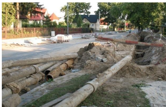
Zdjęcie 9 Rury azbestowo-cementowe
