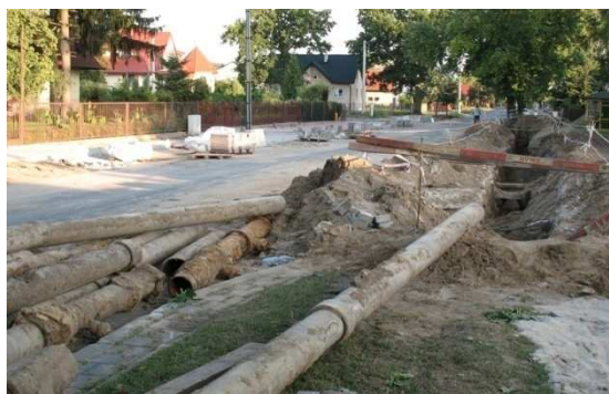
Zdjęcie 9 Rury azbestowo-cementowe
