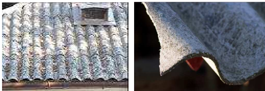
Zdjęcie 7 Płyty faliste azbestowo-cementowych
