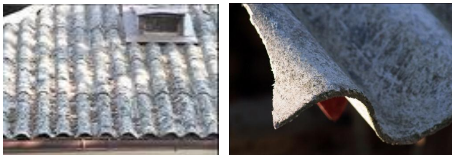
Zdjęcie 7 Płyty faliste azbestowo-cementowych
